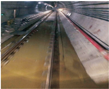
图 14 某车站洞门涌水涌砂
