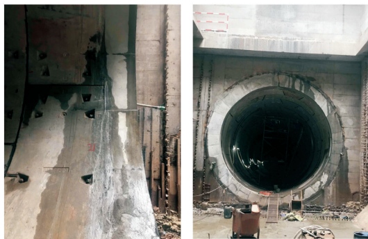
图19 轨道未铺设前洞门渗漏水情况
